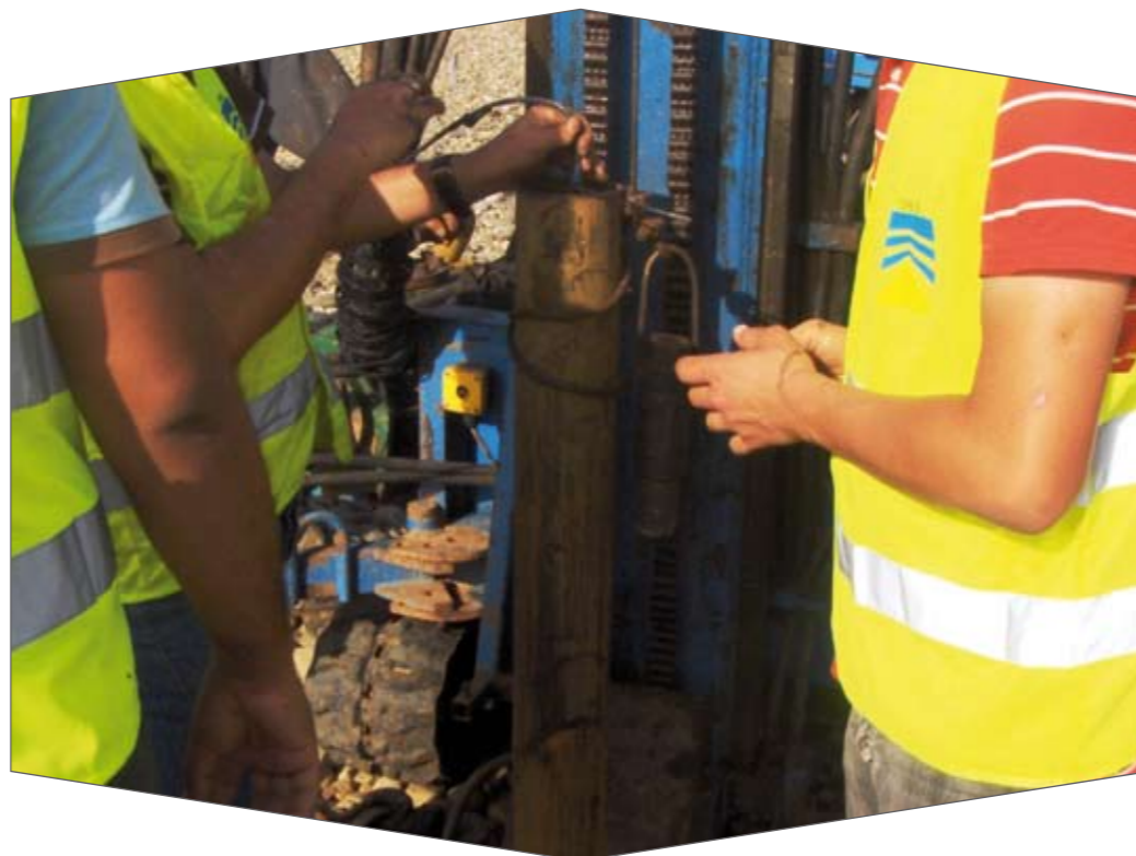
Installation de CPI à corde vibrante dans un des forages.
